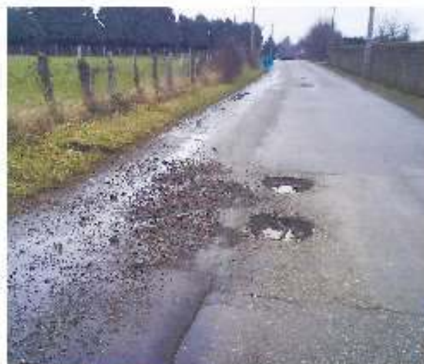
Dégradation de la voie
