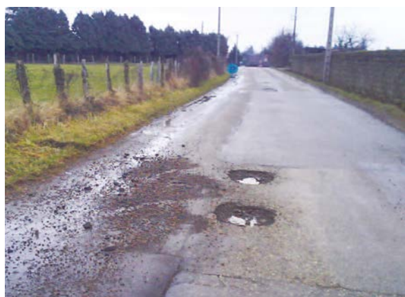
Dégradation de la voie
