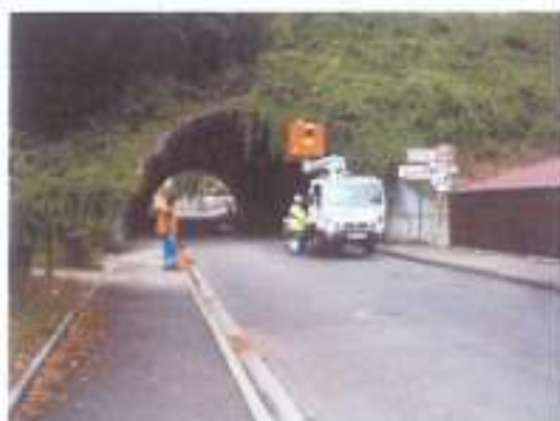
RD 910 – Dévégétalisation aux abords d'un ouvrage d'art
