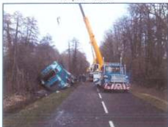
Intervention sur accident PL – Mise en place de déviation, nettoyage et sécurisation des abords avant remise en circulation
