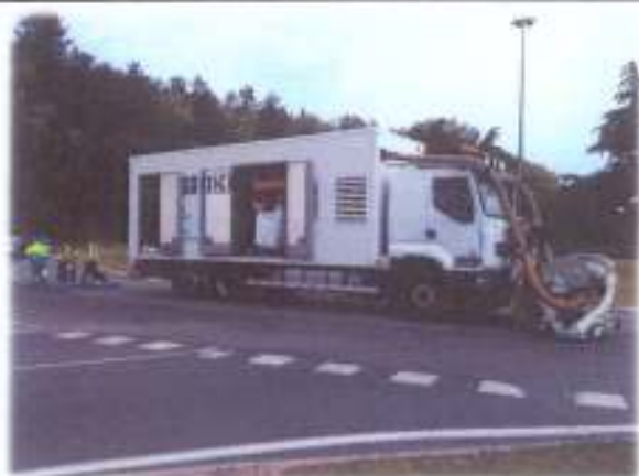
RD 910 – Opération de GRENAILLAGE - Travaux d'amélioration de la rugosité et de l'adhérence du giratoire de Nerpuy
