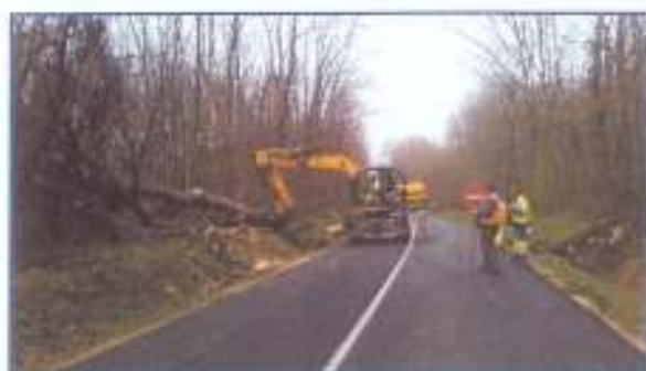
Déblaiement de la chaussée de la RD 727 après le passage de la tempête « Zeus »
