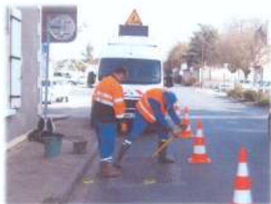
RD 725 – Relevé de chambres fibres optiques
