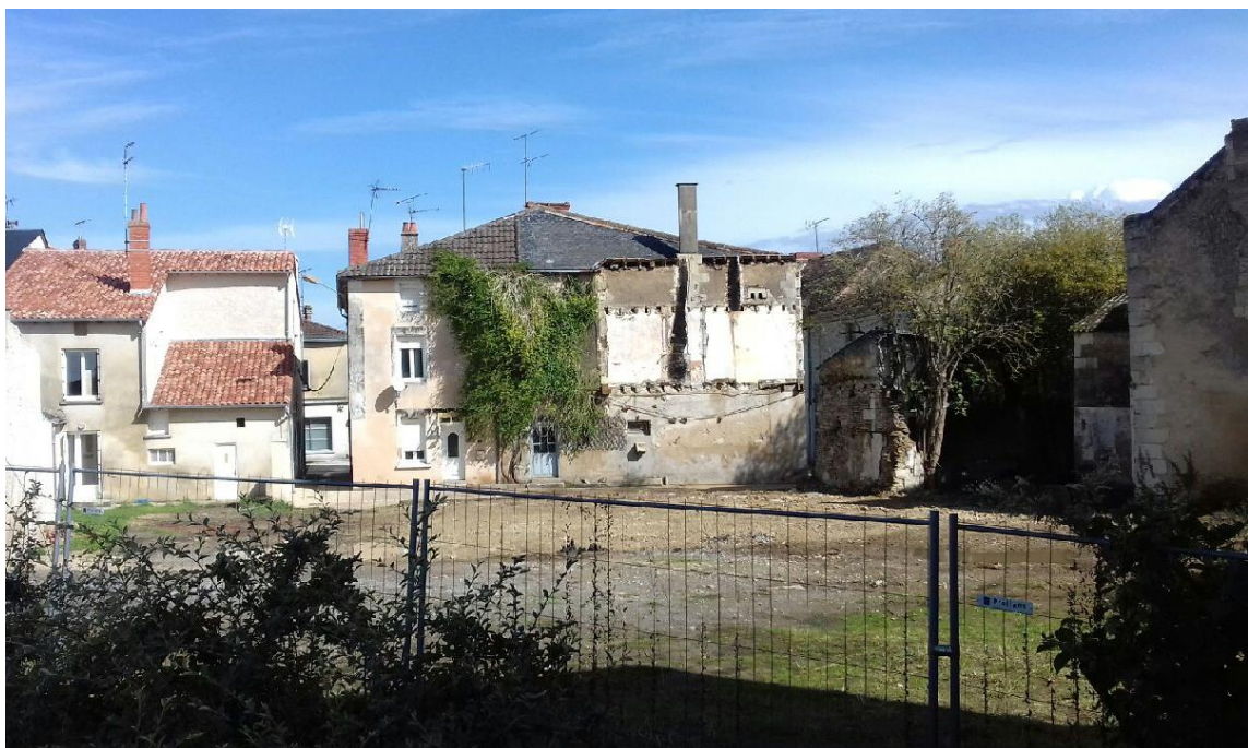
Chantier de densification du centre de Lenclôtre dans le cadre de l'appel à projets
